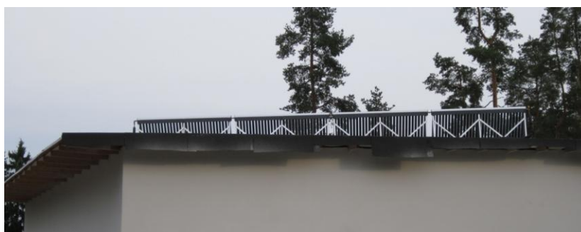
Kuva 2.4. Tyhjöputkikeräimiä katolla Espoon Laajalahdessa 10
